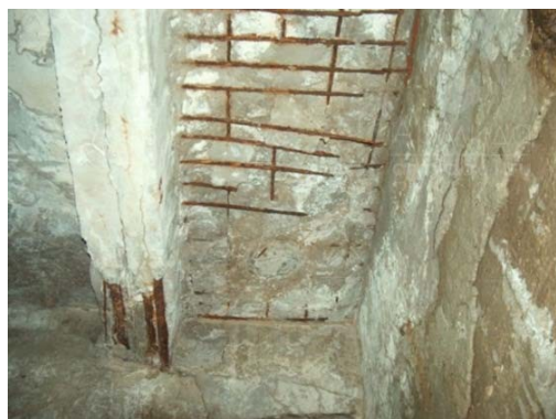
Рис. 6.2. Магнезиальная коррозия бетона
