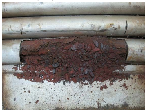
Рис. 6.3. Коррозия металлической трубы
